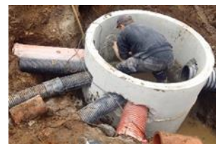
Samle brønd med mange tilløb før sandfanget.
